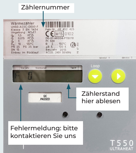
Hinweise zur Ablesung des Wärmeverbrauchs
