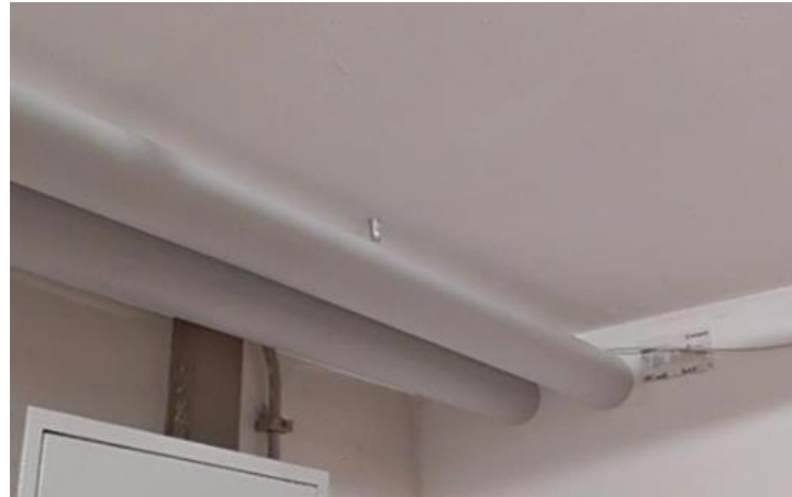
Brandschott durch Kommunwand
