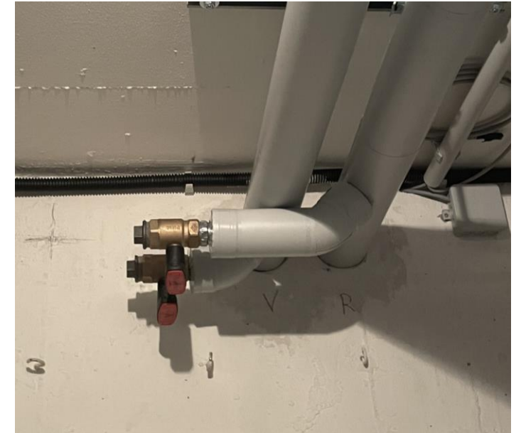
Vorsorgeanschluss mit Absperrkugelhahn
